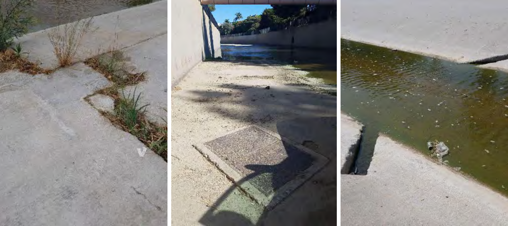
Figura 367. Recubrimiento del canal, escotilla de sub-drenaje, y agujero de drenaje a lo largo del canal del Río de Los Ángeles. Fuente Geosyntec, 2018.
