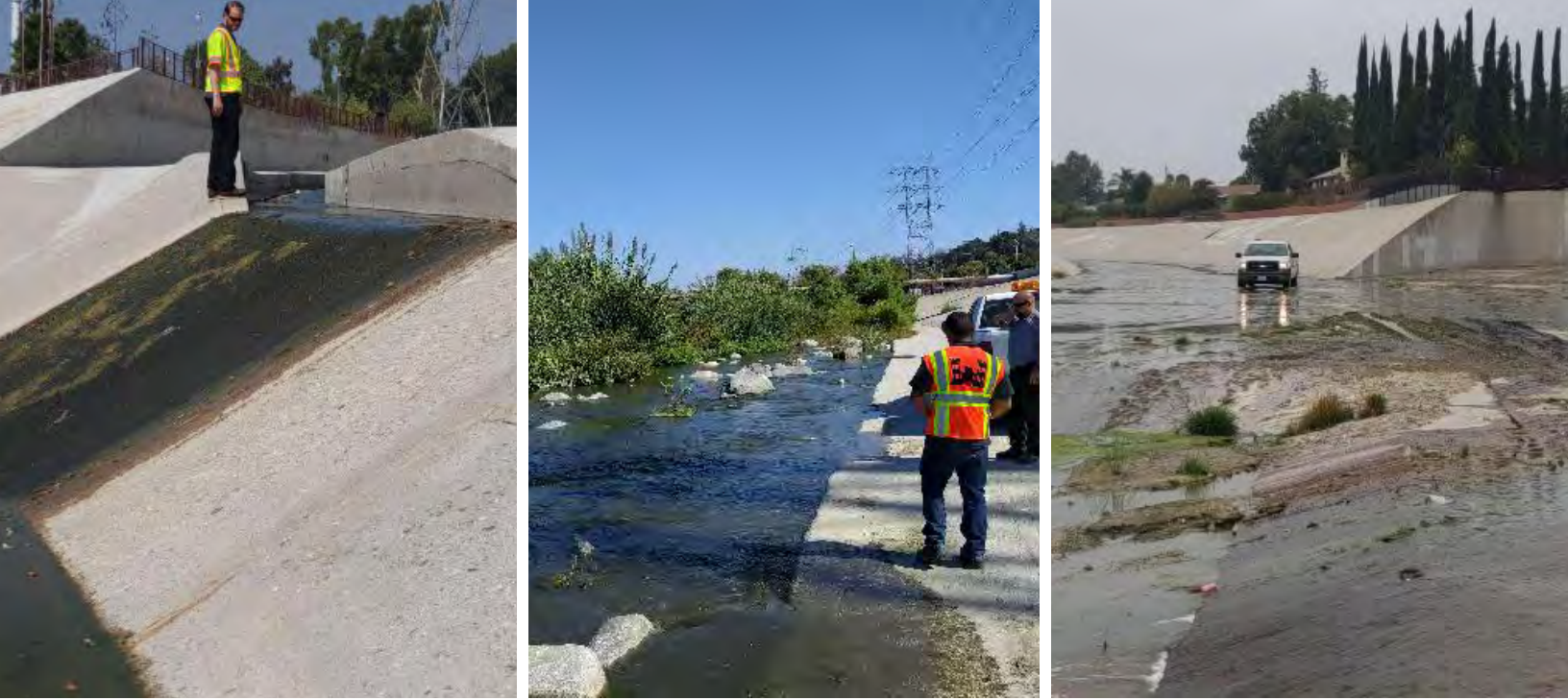
Figura 370. Desagüe, vegetación de fondo, inspección del fondo del río. Fuente: Geosyntec, 2018.
