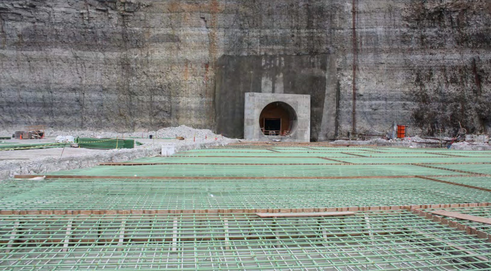
Figura 279. El exceso de lluvia y el desbordamiento combinado de aguas residuales atraviesan una serie de túneles profundos debajo del condado de Cook en Illinois. El agua se descarga en grandes depósitos donde se mantiene hasta que pueda ser tratada y devuelta al sistema de agua. Fuente: OLIN, 2019.
